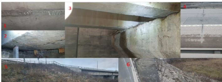
5 pav. 1) I tipo betono korozija, 2) armatūros apsauginio sluoksnio nutrupėjimas, 3) armatūros korozija, 4) kelio dangos pažaidos, 5) biokorozija, 6) siūlių plyšiai.
