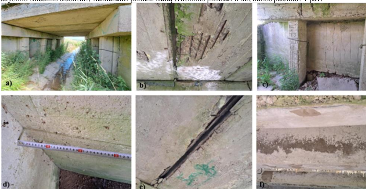
1 pav. Užfiksuotos tiltų pažaidos (a) kairės pusės atraminių polių įlinkis; b) plika tilto pagrindo plokštės armatūra; c) nutrupėjusi ir nuirusi tilto atraminės sienos plokštė; d) 4cm atraminės tilto plokštės įlinkis; e) kiaurymė tarp tilto perdangos plokščių; f) nusidėvėjusi, tilto hidroizoliacija, tarp sandūros plokščių filtruojasi vanduo, išplaunamas kalcio hidroksidas)
