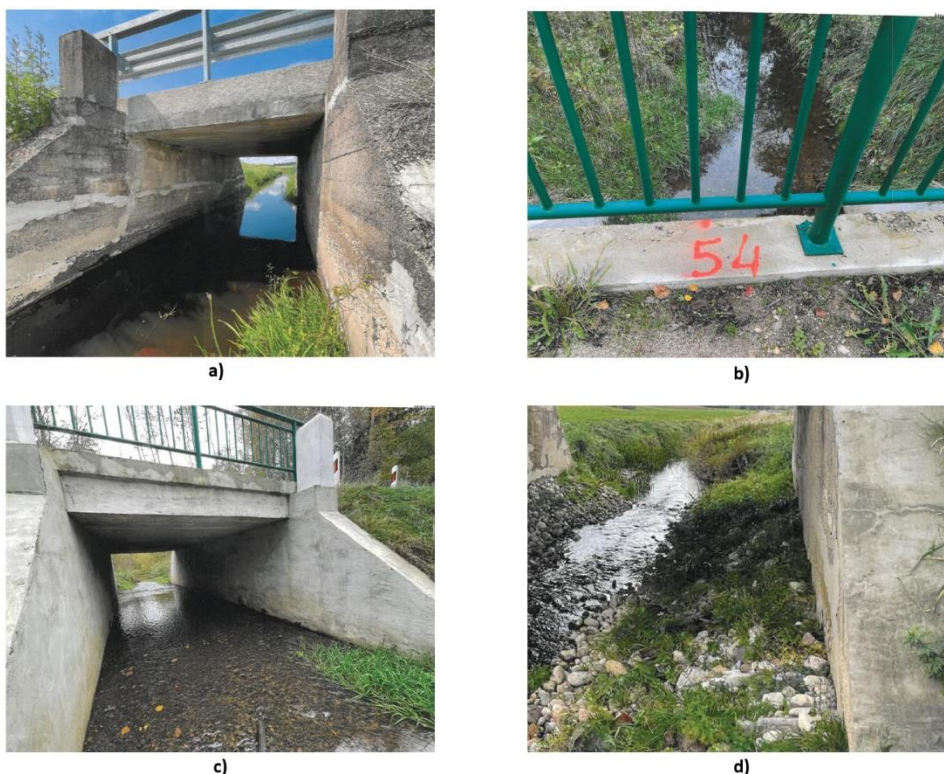
5 pav. Rekonstruotų melioracijos statinių apskaitoje esančių tiltų defektai bei pažeidimai: a) betono paviršiaus spalvos pakitimai ir pažeidimai bei gilūs kalcio karbonato išplovimai atraminių sienų vandens užšalimo – atšalimo ciklo zonose; b) apsauginio betono sluoksnio ištrupėjimai; c) kalcio karbonato išplovimai atraminių sienų vandens užšalimo – atšalimo ciklo zonose; d) apsauginio betono sluoksnio mikro įtrūkimai (Autorės nuotraukos).
