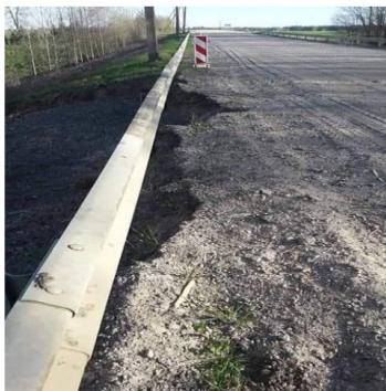
3 pav. Nuslinkęs šlaitas ties Pk 313+53. Nuotrauka iš projekto „Valstybinės reikšmės kelio Nr. 3802 Miknaičiai–Slavikai–Kiduliai...“
