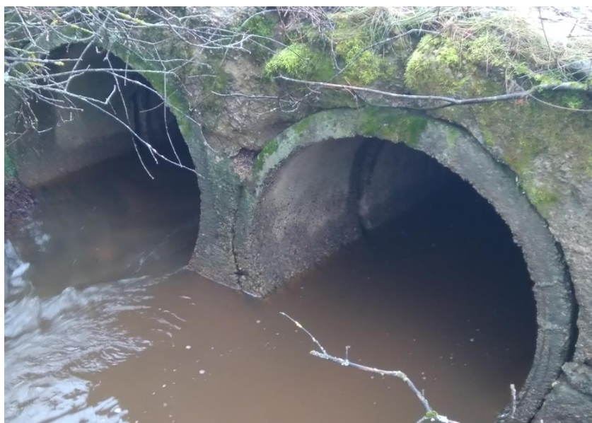
1 pav. Kretingos rajone Baublių k. v. esanti nepatenkinamos būklės pralaida Fig. 1 In Kretinga district Baublių k. v., existing culvert in unsatisfactory technical state
